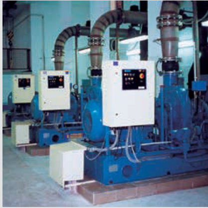
Suwałki Atıksu Arıtma Tesisi Model :DA 253 Miktar : 3 adet Basınç : 60 kPa Güç : 330 kW
