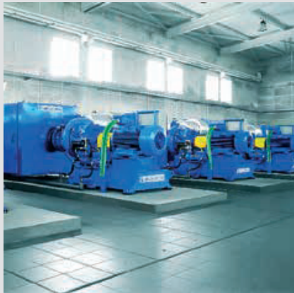
Poznań Merkezi Atıksu Arıtma Tesisi Model :DA 340 Miktar : 12 adet Basınç : 65 kPa Güç : 2400 kW
