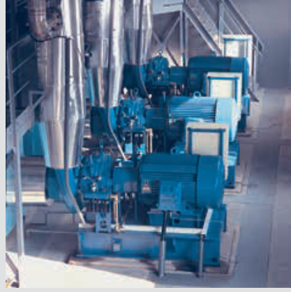
Tarnów Atıksu Arıtma Tesisi Model :DA 340 Miktar : 3 adet Basınç : 60 kPa Güç : 600 kW
